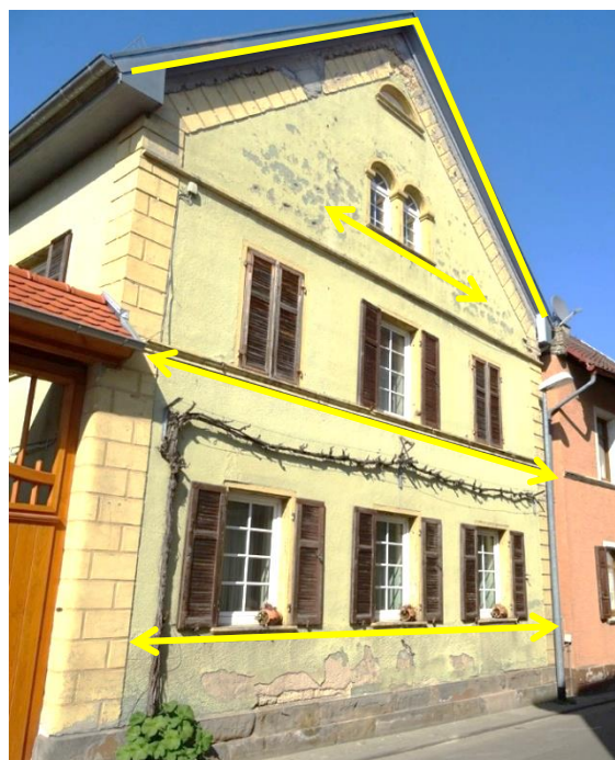
Auch sind hier die Fenster gleichgroß und liegen horizontal, in regelmäßigen Abständen, bandartig auf einer Linie.
