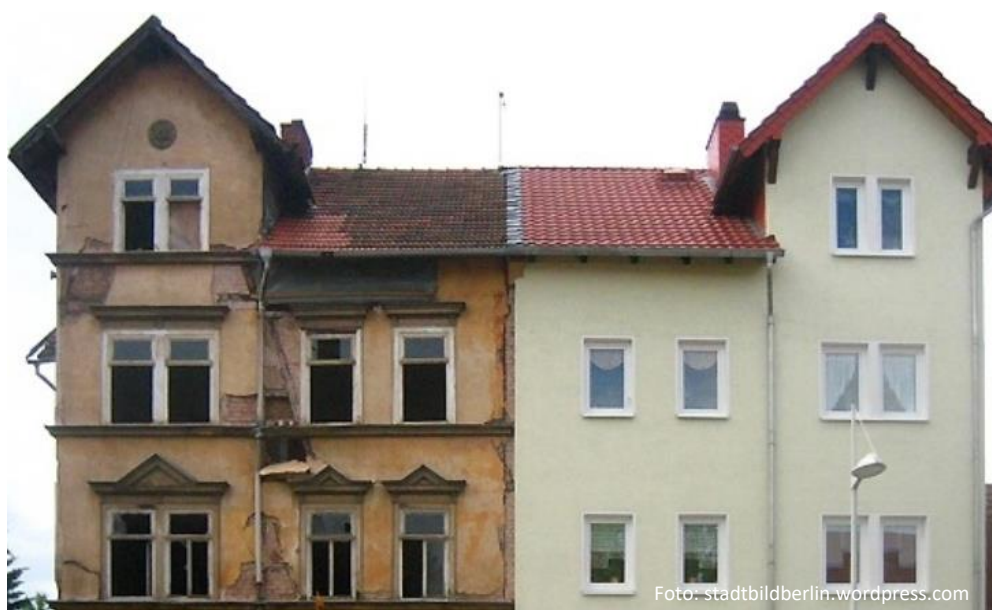
Negativbeispiel: bei der rechten Gebäudehälfte wurde der historisch, ortsbildprägende Charakter (mit Fenstergeränden und Umlaufbändern) durch die Fassadendämmung zerstört.
